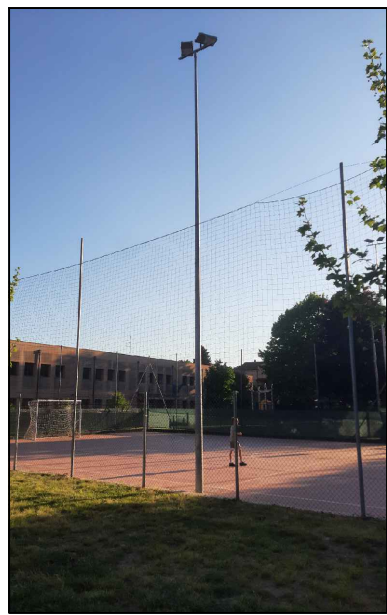
Foto 13 - punto luce h=10 m Armatura stradale braccio singolo tipo Carboni group mod. Newton (TIPO 2)
